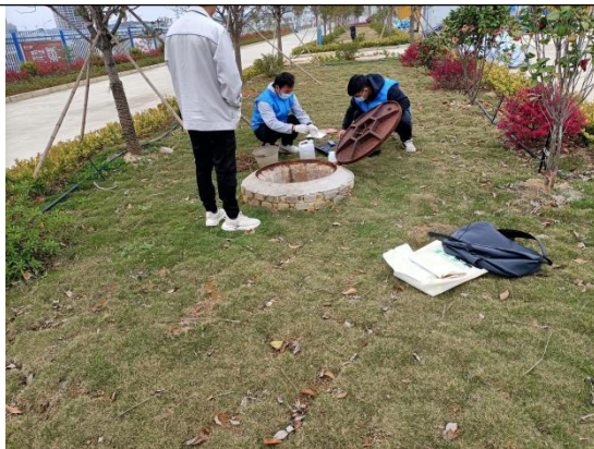
生活污水（化粪池）
