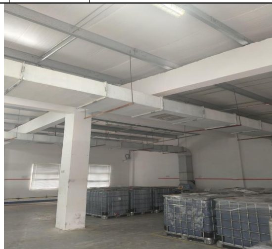
危险废物暂存间通风设施及危废品储存
