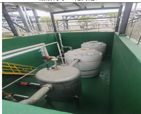
锂离子电池电解液生产线生产废水收集池
