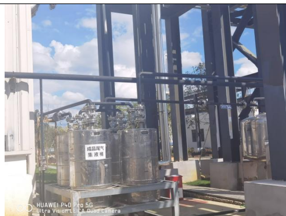
生产线废气处理设施
