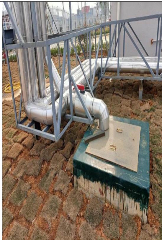
废水处理站事故应急池
