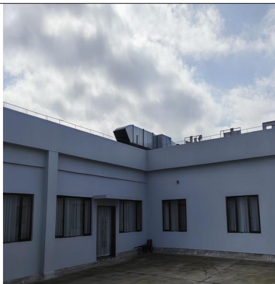
排气筒（注：右侧为蒸煮的蒸汽排放口）
