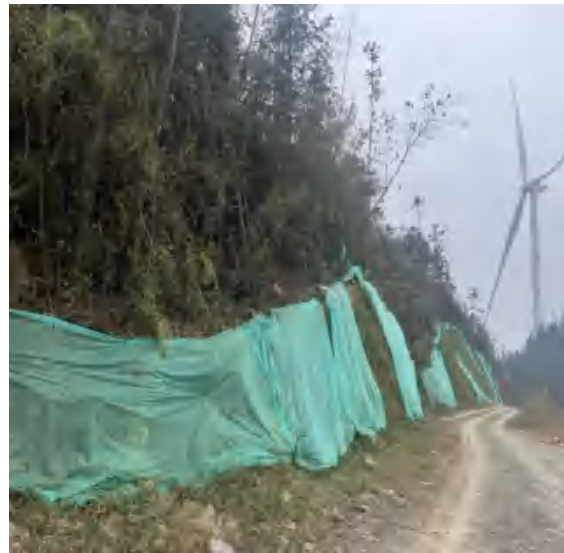
13#新建道路区上边坡喷播植草和裸露地表植被生长情况
