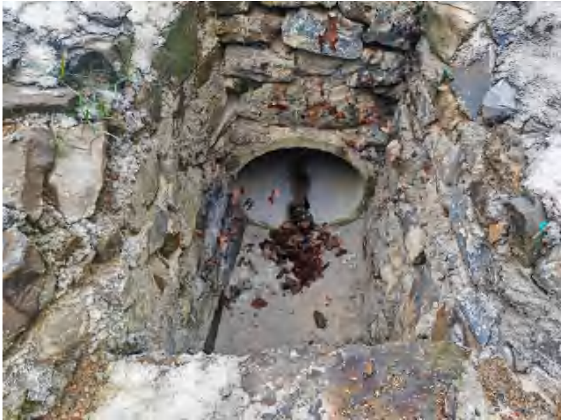
9号道路沉沙池和排水涵管
