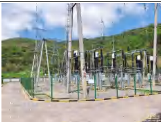
220kV 配电设备 (AIS)
