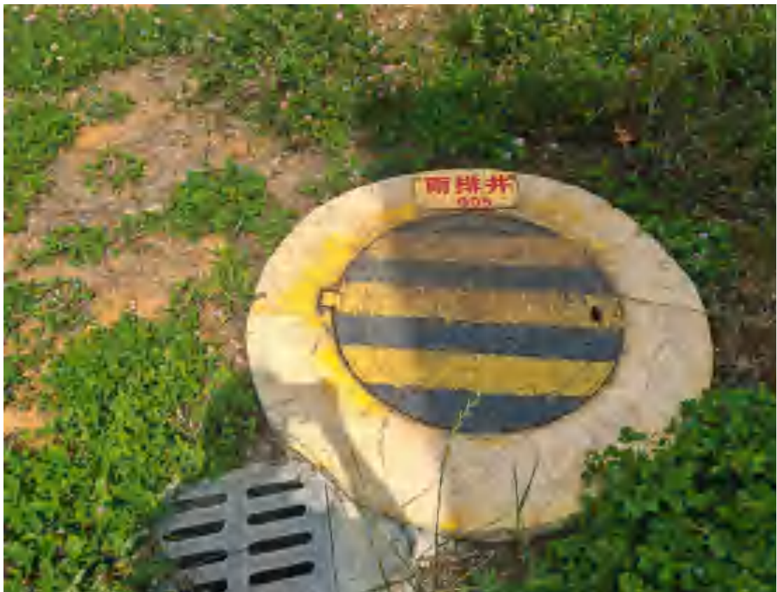
升压站排水系统（2024.05.14）
