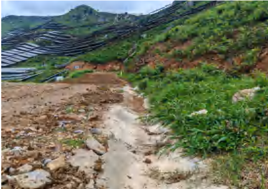
光伏道路区已建 U 型排水沟和植被建设情况（近照）（2024.05.14）
