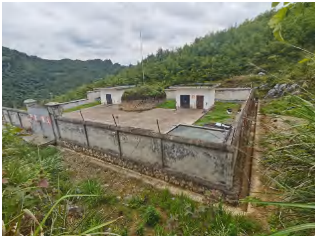
炸药库排水系统及植被建设
