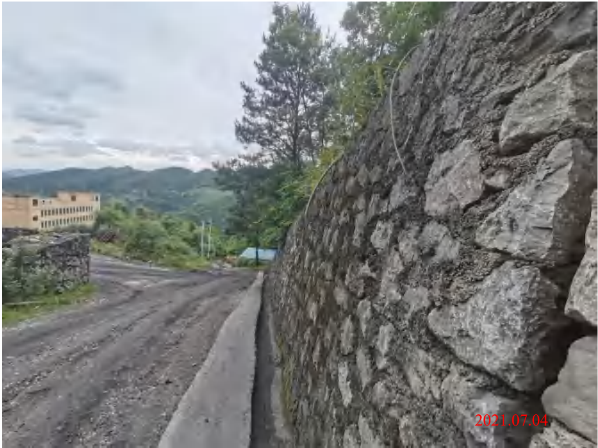
副井道路排水系统及综合护坡
