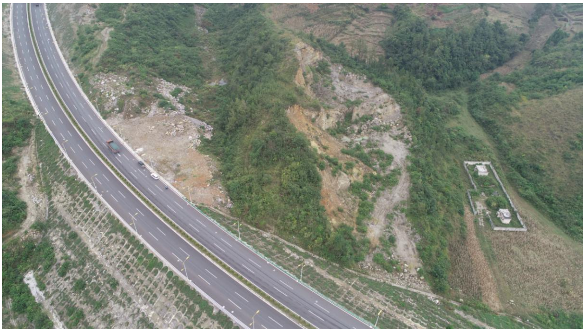
监测小组人员使用无人机巡查调查取料场及路基水土保持措施实施情况
