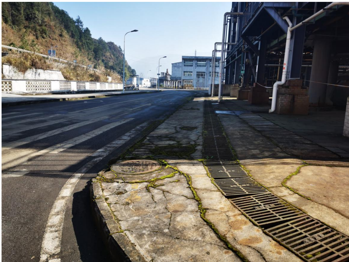
厂区（生产区）排水措施
