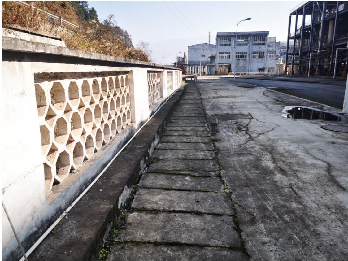
厂区（生产区）排水措施
