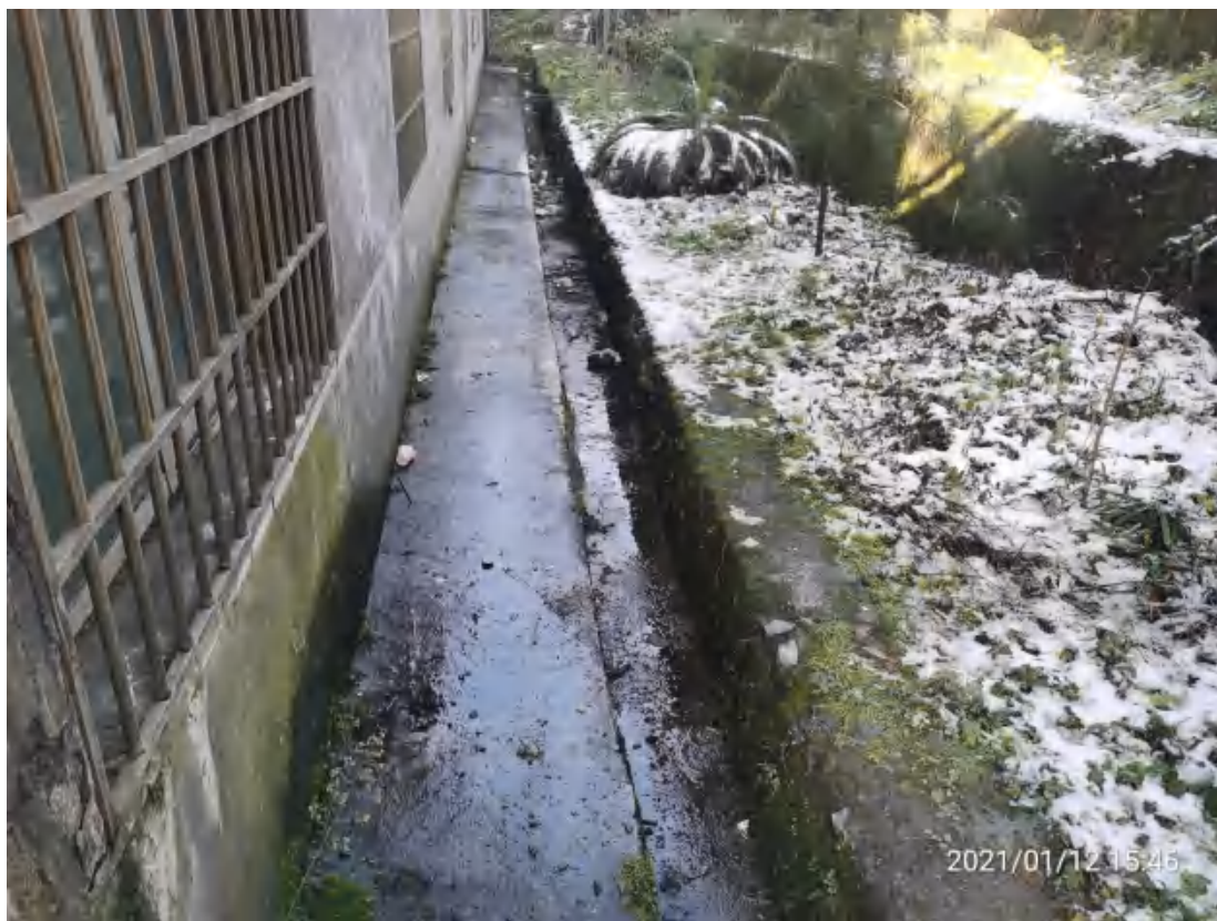
工业场地排水沟
