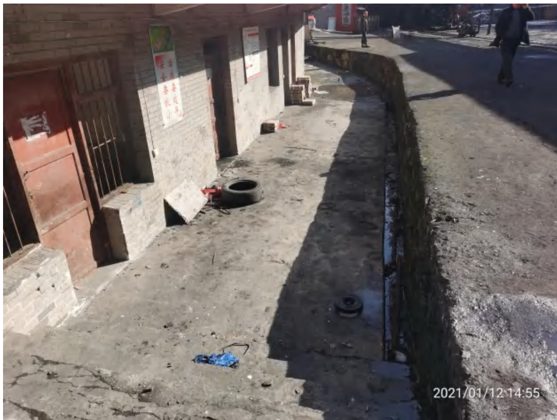
工业场地排水沟
