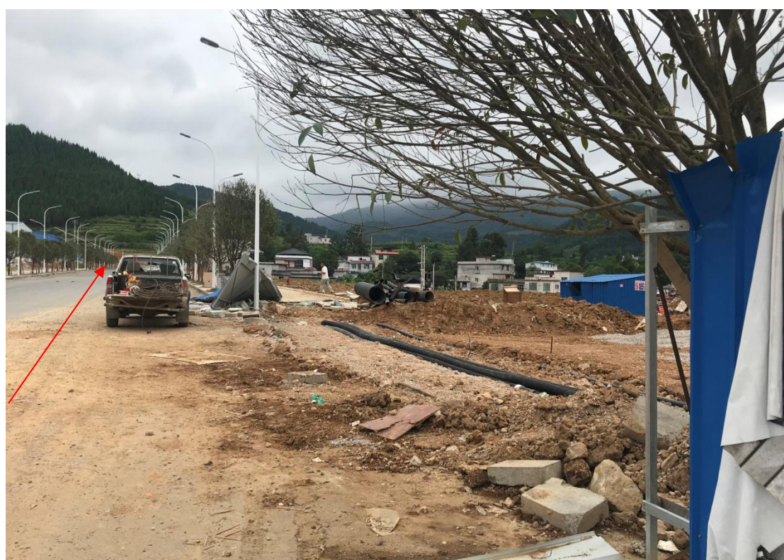
K0+080 (本项目已完工, 被周边建设破坏)
